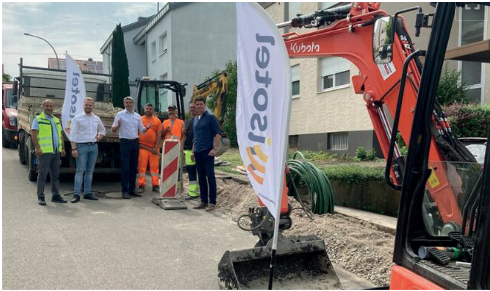
Bauleiter, Kevin Kronenbitter, bei Wisotel Gebietsleiter, Bürgermeister Jürgen Kiesel, Bauarbeiter und Ralf Straßberger, Wisotel-Geschäftsführer, (v.l.) an der Baustelle in der Nelkenstraße. © Uwe Speiser
